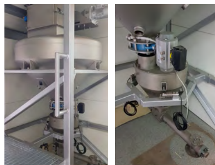
Rysunek 2. i 3. Urządzenia technologiczne
